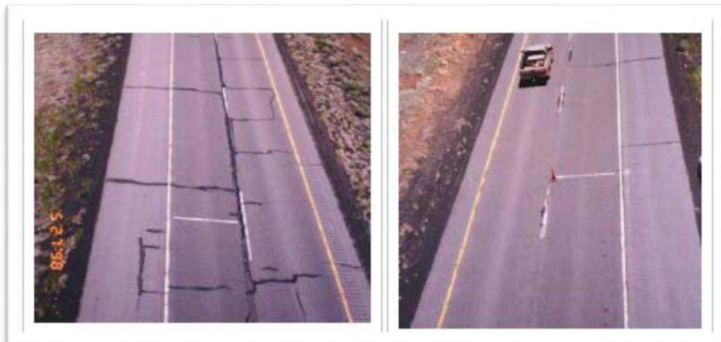
Εικόνα 25 – Αριστερά: δρόμος με συμβατικό ασφαλτόμιγμα, δεξιά: δρόμος με τρίμμα ελαστικού(1990) - Λήψη της φωτογραφίας (1998)
